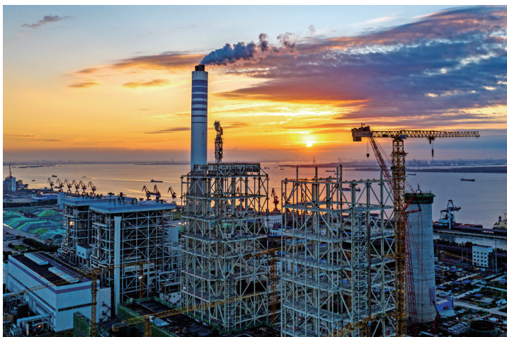
国信靖江2×100万千瓦机组扩建项目脱硫装置总承包
