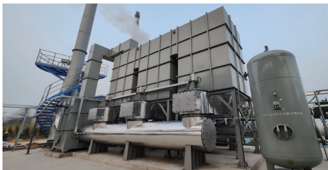
油港国际港务有限公司油气回收装置升级
