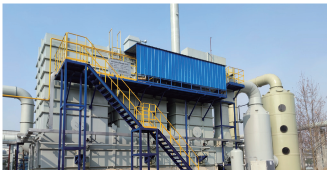
江阴技源药业有限公司废气治理
