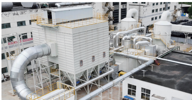
江苏双钱橡胶尾气VOCs综合治理
