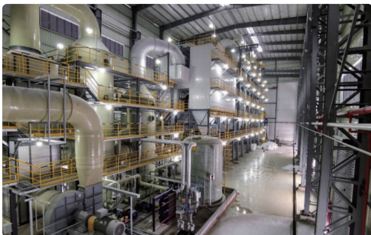
包钢集团绿源危废焚烧项目
