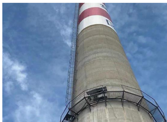
废气采样口和采样平台
