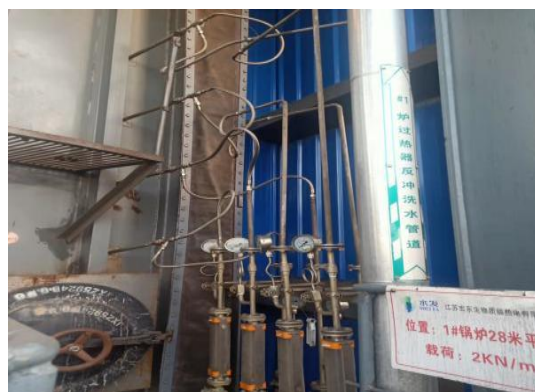
SNCR 脱硝设施
