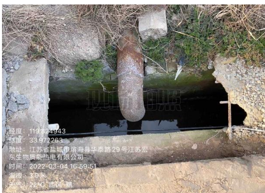
循环冷却水排口
