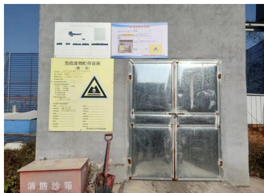
现有危废暂存间
