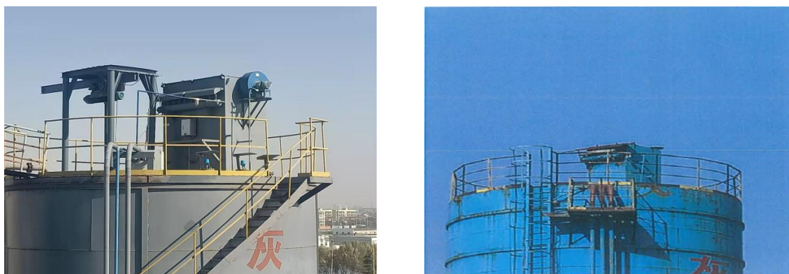
图 4.1-3 料仓、灰库呼吸废气布袋除尘器
