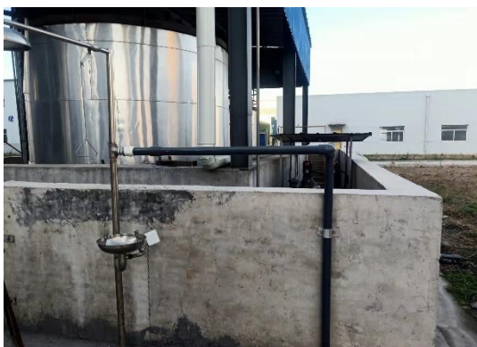
氨水罐区围堰
