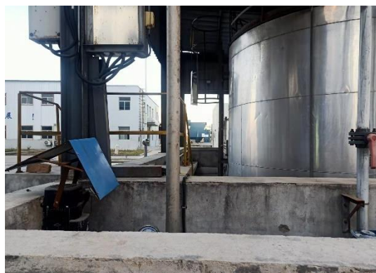
氨水罐区围堰
