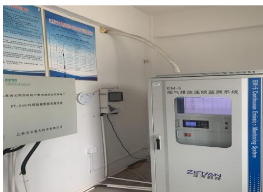
烟气排放连续监测系统
